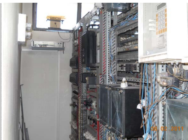
Slika 2. Izgled montiranog uređaja
